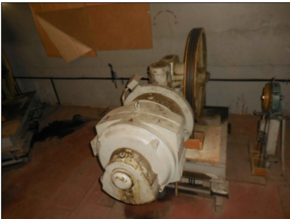
Фото 4. Расположение лебедки в машинном помещении
